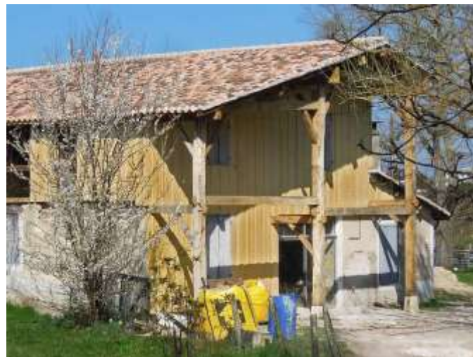
Auvent en cours de réalisation avec des bois fournis par Marc Lafond. JC de Munain Architecte
